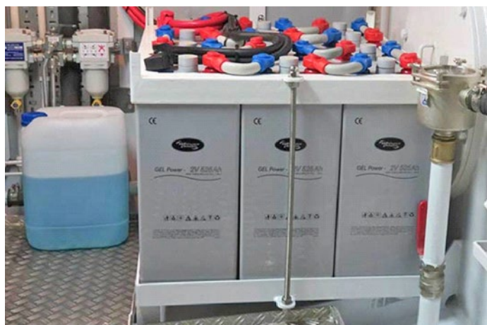
Rys. 8. Lokalizacja zespołu akumulatorów pod pokładem [17] (analiza podłączenia: akumulatory zabezpieczone przeciw przemieszczaniu, dobra wentylacja zastosowanie osłon terminali, brak potencjalnych źródeł ciepła)
