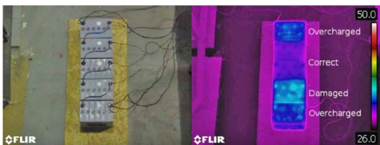
Rys. 22. Wizualizacja rozkładu temperatury akumulatorów sprawnych (correct) i uszkodzonych (damaged) lub przeładowanych (overcharged) [26]
