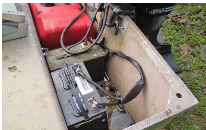
Rys. 7. Lokalizacja akumulatora 12 V [16] (analiza podłączenia: dobra wentylacja, brak osłon terminali/akumulatora (akumulator narażony na działanie czynników zewnętrznych), akumulator niezabezpieczony przeciw przemieszczaniu, akumulator zlokalizowany blisko zbiornika paliwa)
